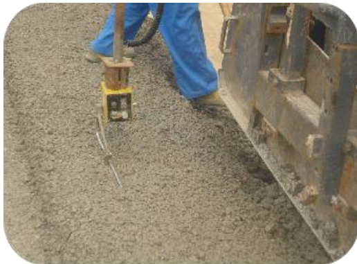
图 48 摊铺搭接宽度不足
