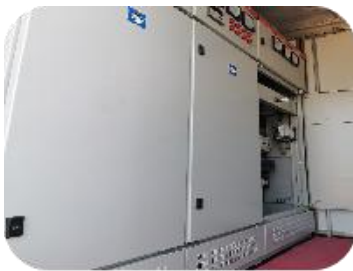
图 131 配电柜调试装置
