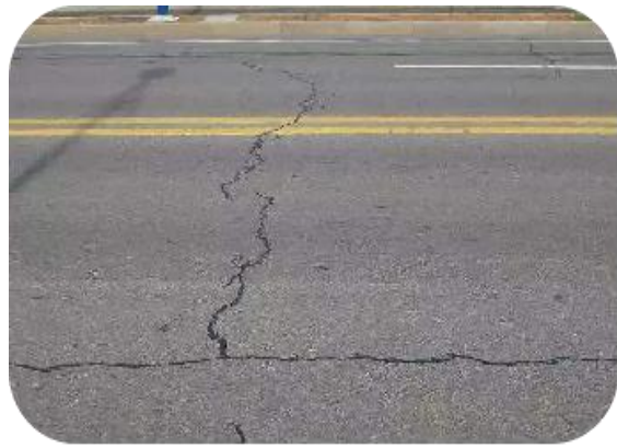
图 75 道路反射裂缝
