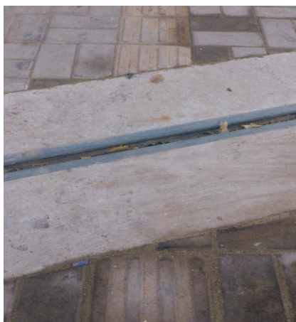
图 218 人形坡道未零高差
