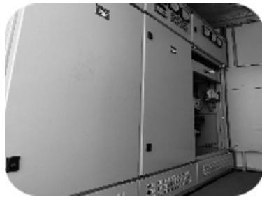
图 7.2.7-2 配电柜调试装置
