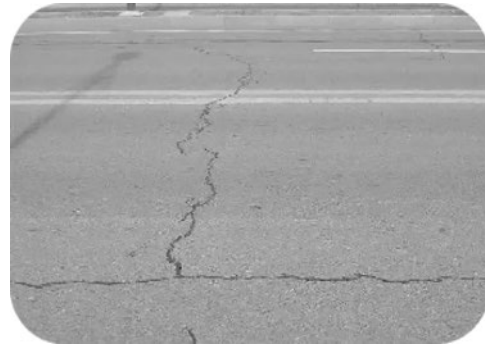
图 5.3.3-2 道路反射裂缝
